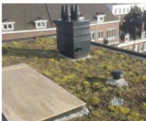
©Joru support greenroof extensief groendak
