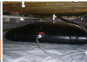
regenwaterzak in kruipkelder
